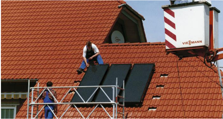
Eine finanzielle Versorgerverpflichtung könnte den Anteil der Erneuerbaren im Wärmesektor deutlich steigern. (Quelle: BSW-Solar/Viessmann)
